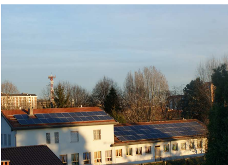
Pannelli impianto fotovoltaico
